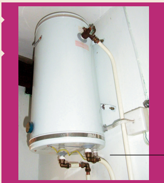
电热水炉如果没有定期检查及维修,损坏了也未能及时察觉。
